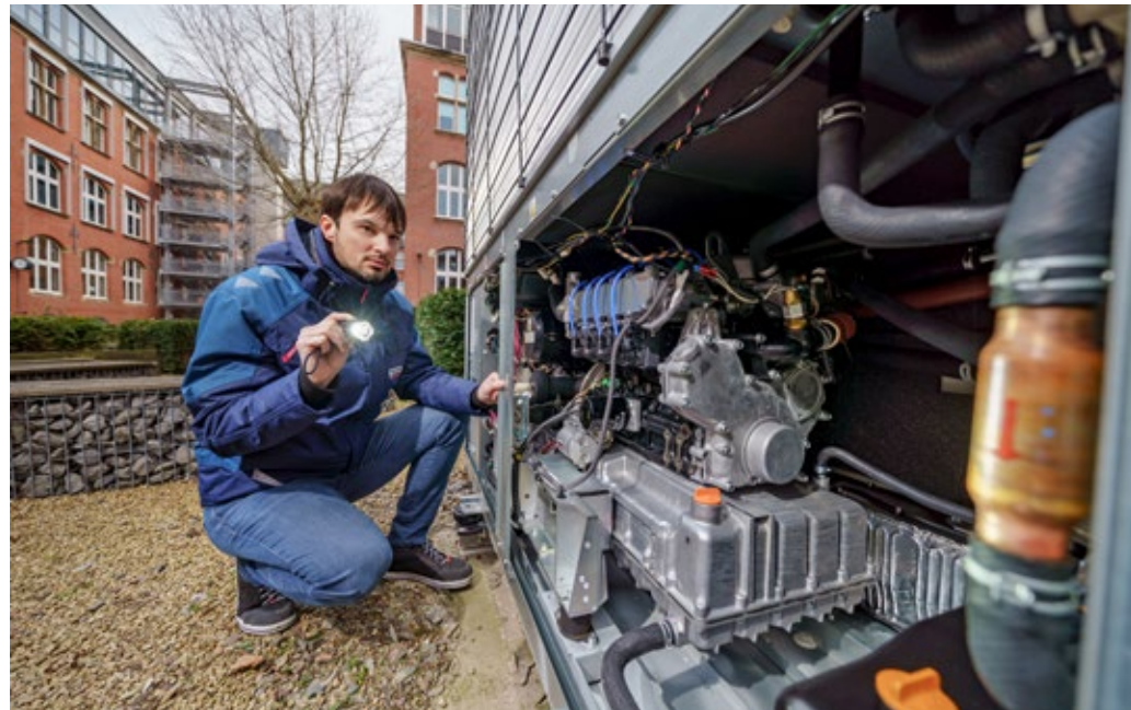
Richie Zubek vom Technischen Dienst präsentiert die Gasmotorwärmepumpe. Sie kombiniert die derzeit effizientesten Energietechniken in einem Gerät und sorgt für ein gutes Klima im Studierendenzentrum.
